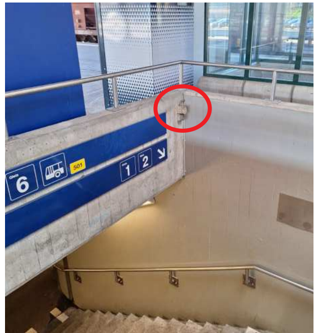
Stromanschluss 230V 13A
