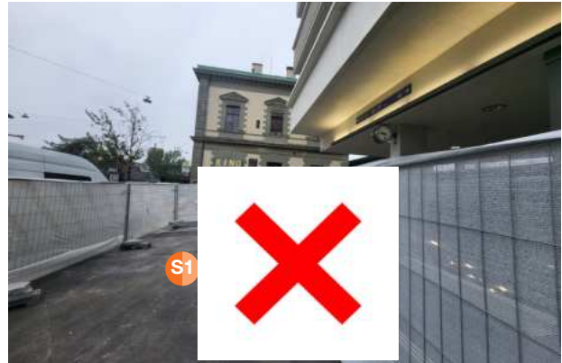
S1 Côté Place de la Gare Sud, 2ème demi-place de distribution, max. 2 promoteurs. Point de distribution fermé pour cause de travaux.
